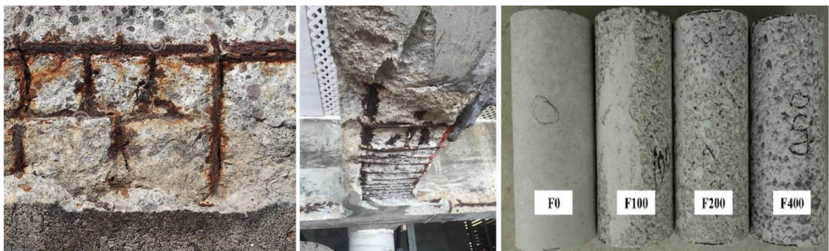
Obr. 11: Odlupování povrchových vrstev betonu [37] [38] [39].
