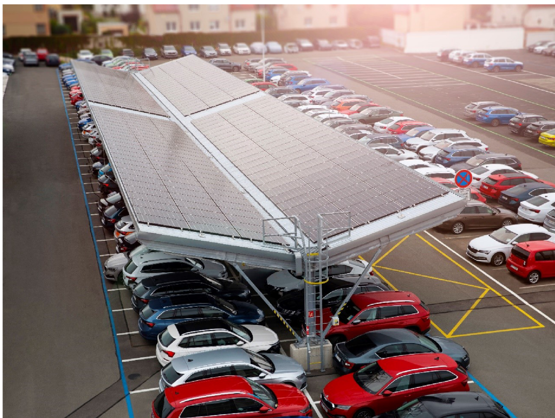
Obr. 4.3 Fotovoltaická elektrárna na oddělení servisu
