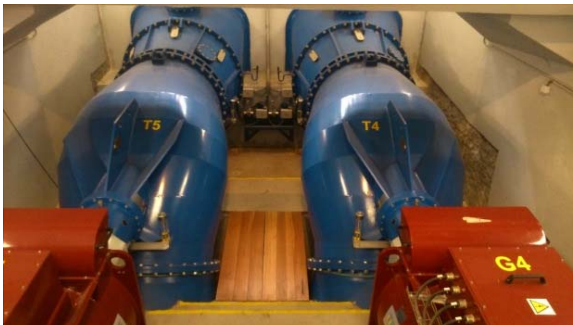
Obrázek 17 Pohled do původní kašna se dvěma novými soustrojemi
