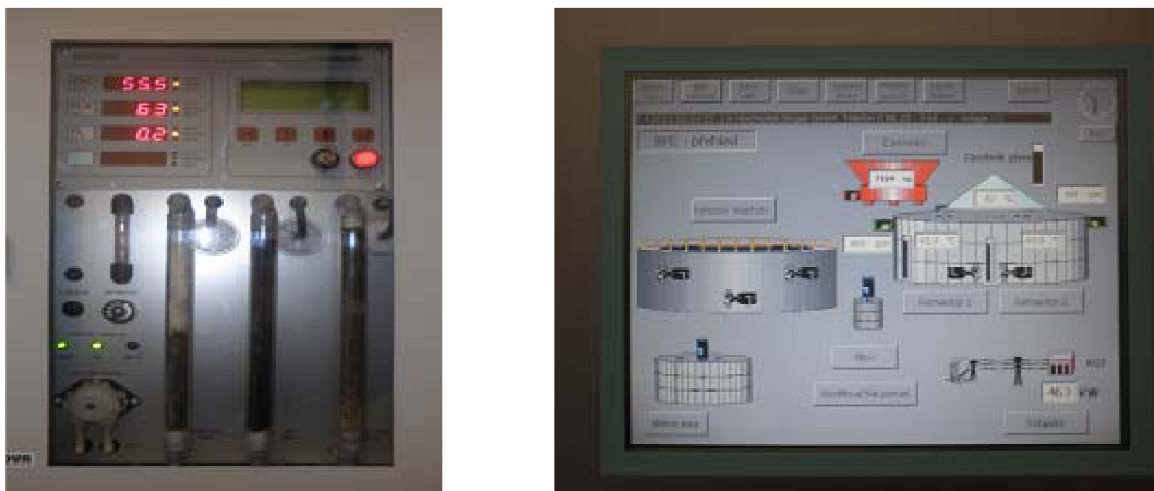
Obr.4. 4 Znárodnění panelů, které slouží ke kontrole chodu BPS
