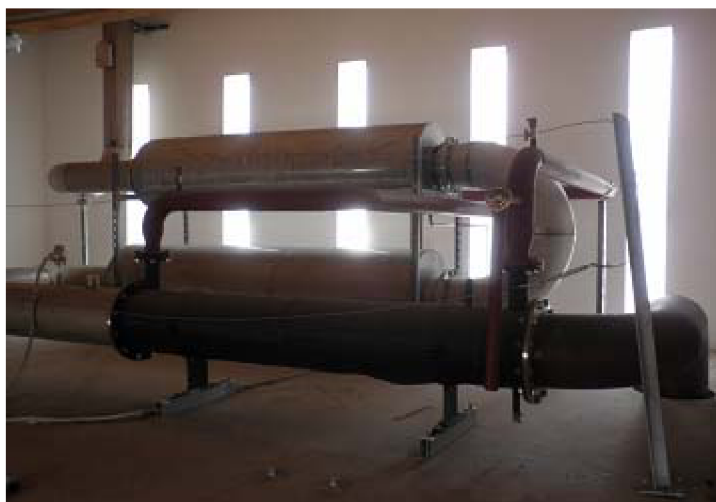
Obr.4. 5 Spalinový výměník s tlumiči hluku
