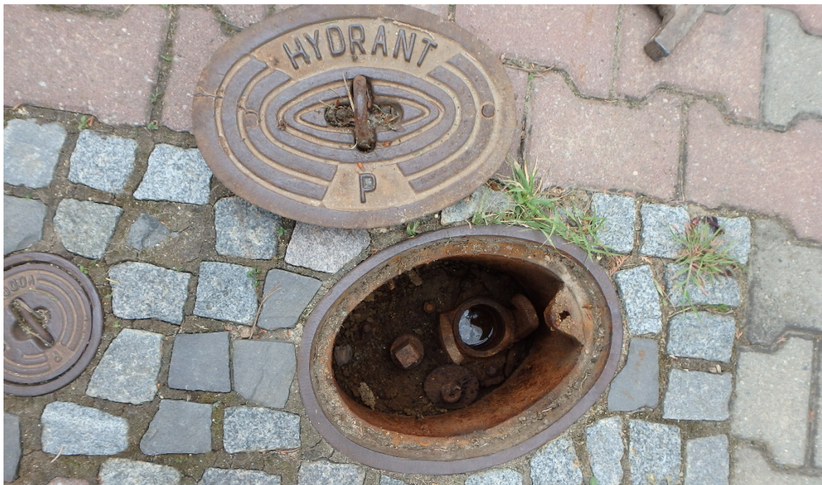
Obr. 21 Podzemní hydrant na ulici Zatloukalova.
