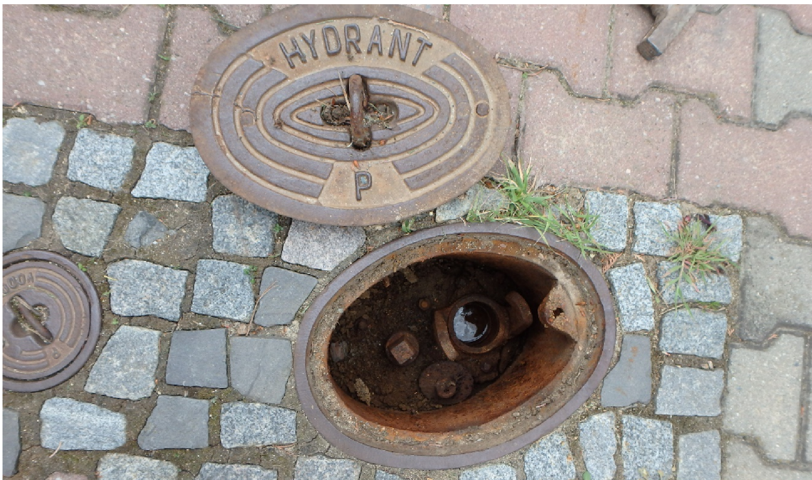
Obr. 21 Podzemní hydrant na ulici Zatloukalova.
