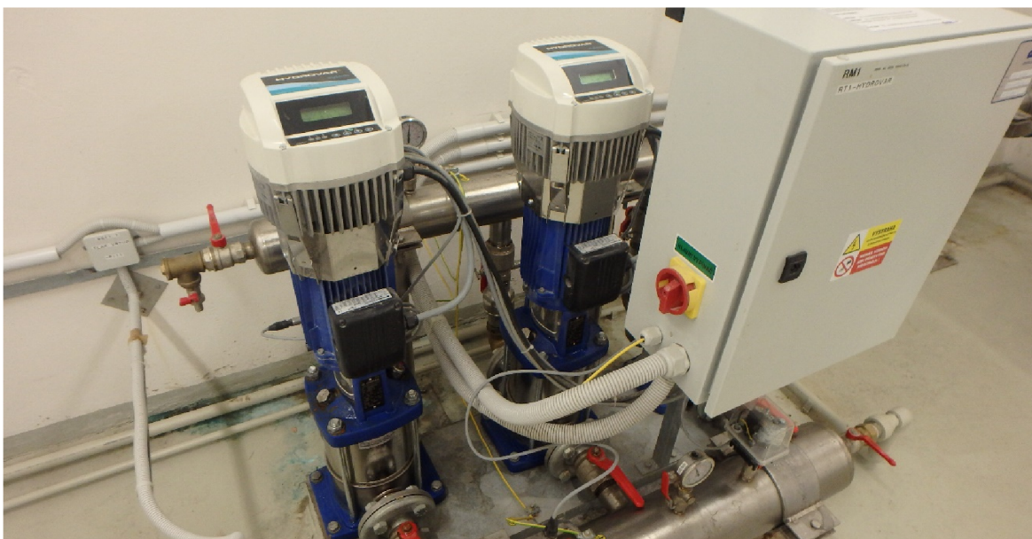
Obr. 31 Čerpadla značky Lowara.
