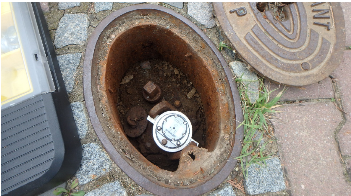
Obr. 22 Osazena měřicí technika značky Seba KMT.
