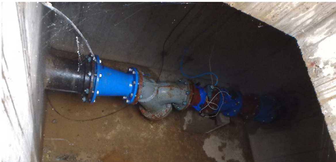
Obr. 29 Vodoměr na odbočce z Březovského přivaděče.
