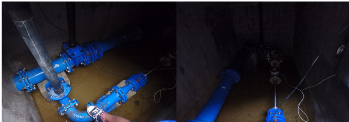
Obr. 32 Pohled do šachty s osazeným redukčním ventilem (vlevo). Redukční ventil CLA-VAL (vpravo).
