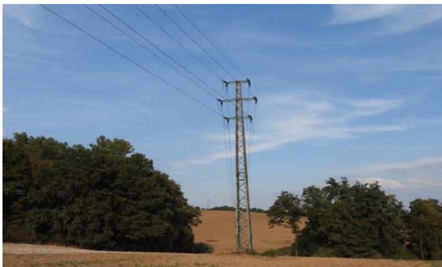
Obrázek č. 15: Nebezpečný příhradový sloup VN (zdroj: Orel, 2015)
