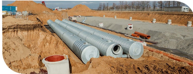
Obrázek č.23: Ocelová nádrž [6]
