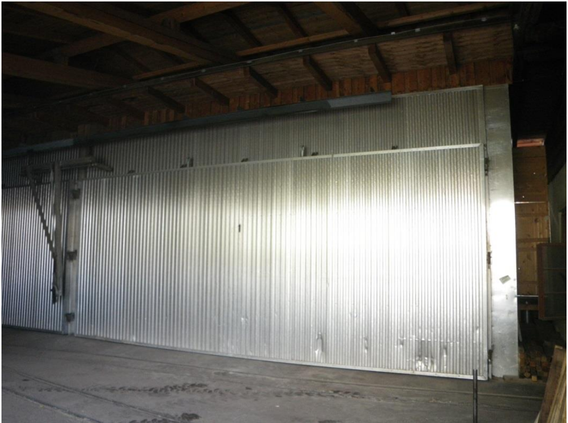
Obr 6 Sušárny řeziva KovoS s.r.o.
