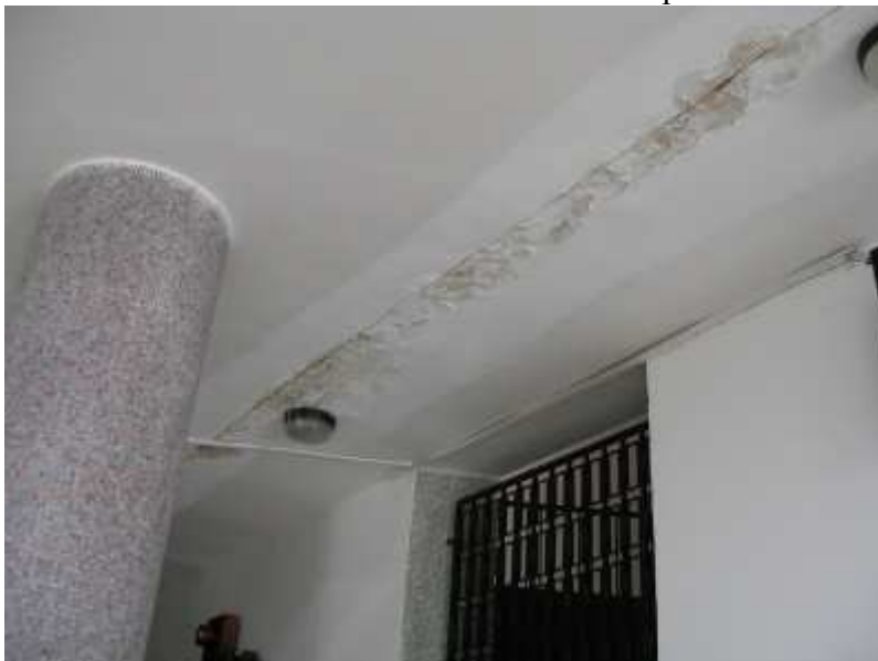
Obrázek č. 5 - Citadela – narušené zdivo http://www.mulitvinov.cz/ ]
