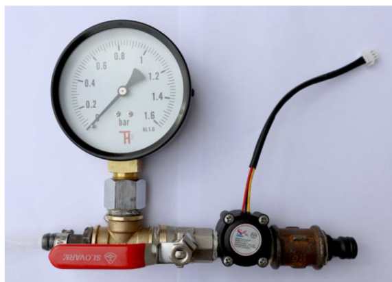
Obrázek 3.18 Použitá měřicí armatura
