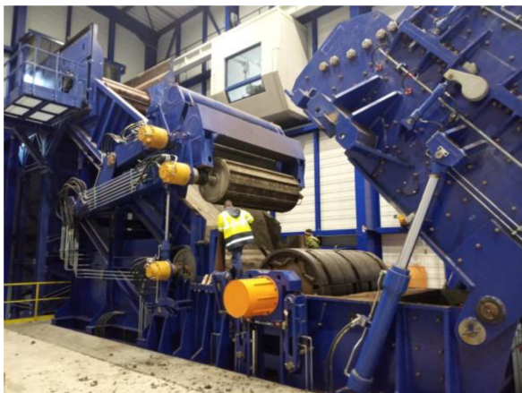
Obrázek 11 - Šrédr společnosti Recycling-kovové odpady a.s.
