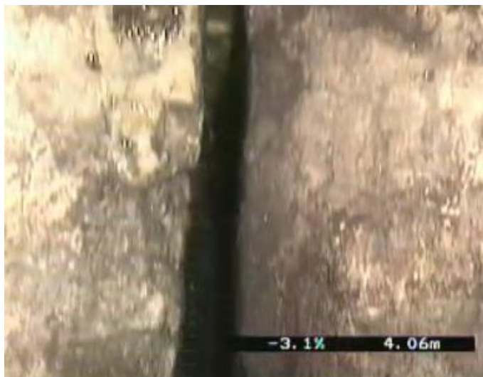
Obr. 4.13 Fotografie detailu vychýlení (netěsnosti) kanalizační trouby v úseku 116684 [75]
