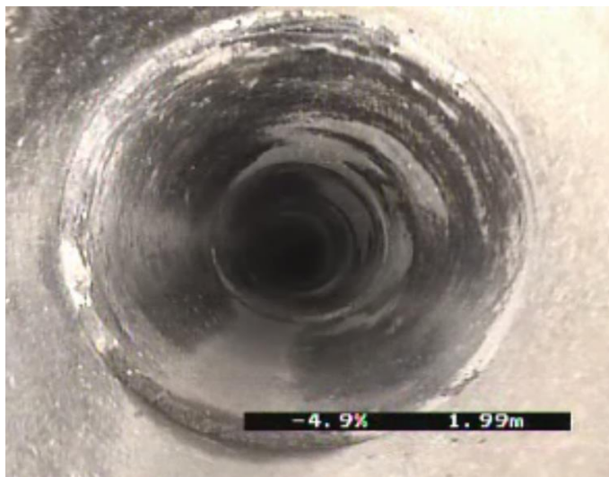
Obr. 4.9 Fotografie vychýlení kanalizační trouby v úseku 116683 [75]
