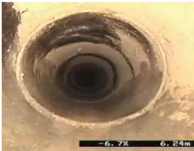
Obr. 4.7 Fotografie vychýlení kanalizační trouby v úseku 116681 [75]
