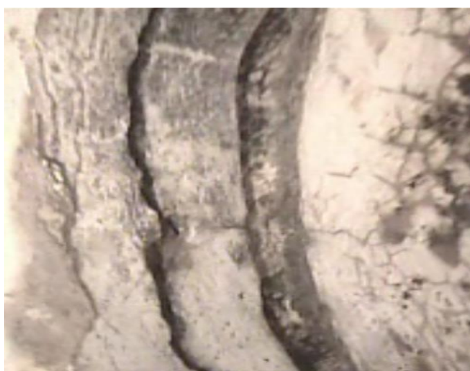
Obr. 4.14 Fotografie detailu trhliny na vnitřní stěně potrubí úseku 116514 [75]
