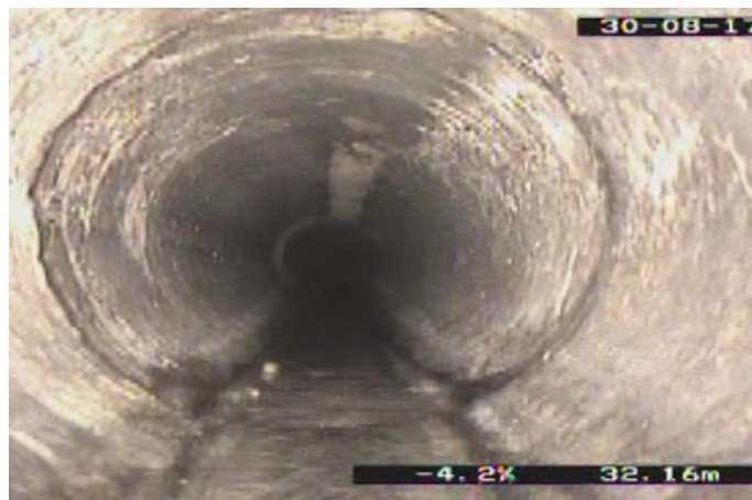
Obr. 4.19 Fotografie vychýlení potrubí na úseku 122203 [75]
