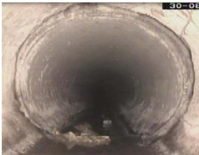
Obr. 4.15 Fotografie zanášení stoky ve vychýlení mezi troubami na úseku 116685 [75]
