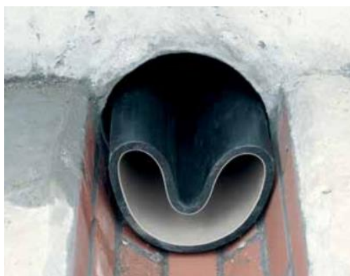
Obr. 2.15 Detail deformovaného potrubí [19]
