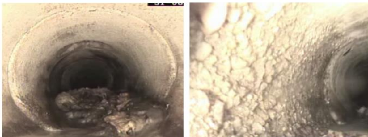
Obr. 4.22 Fotografie usazování částic odpadní vody ve vychýleném spoji, napadení vnitřní stěny potrubí úseku síranovou korozí (vpravo) [75]
