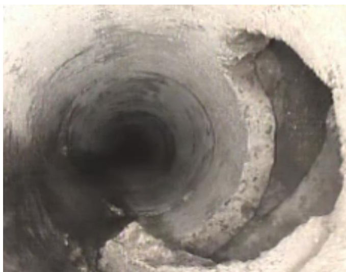
Obr. 4.24 Fotografie neodborně zaústěné přípojky do úseku 116511 [75]
