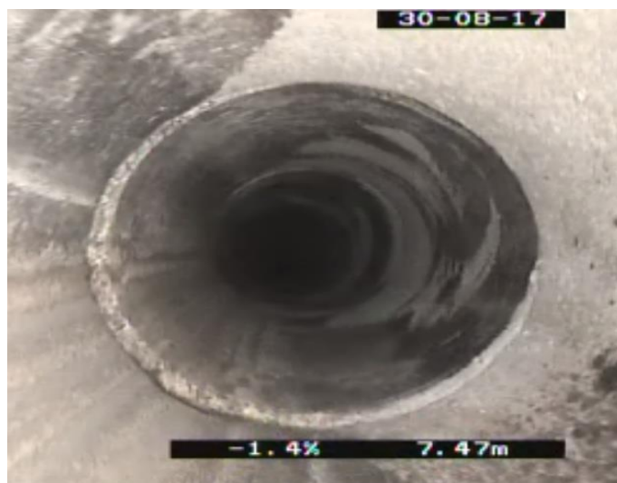
Obr. 4.11 Fotografie vychýlení kanalizační trouby v úseku 120346 [75]
