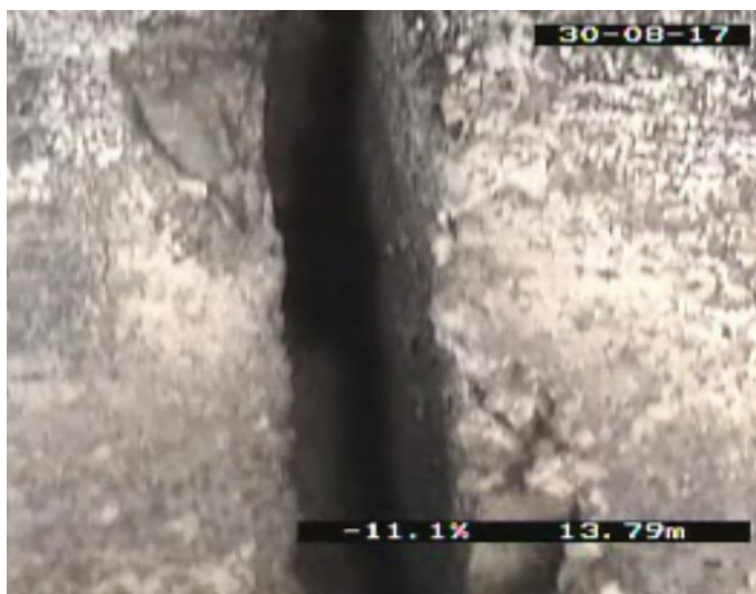
Obr. 4.10 Fotografie detailu vychýlení (netěsnosti) kanalizační trouby v úseku 116683 [75]
