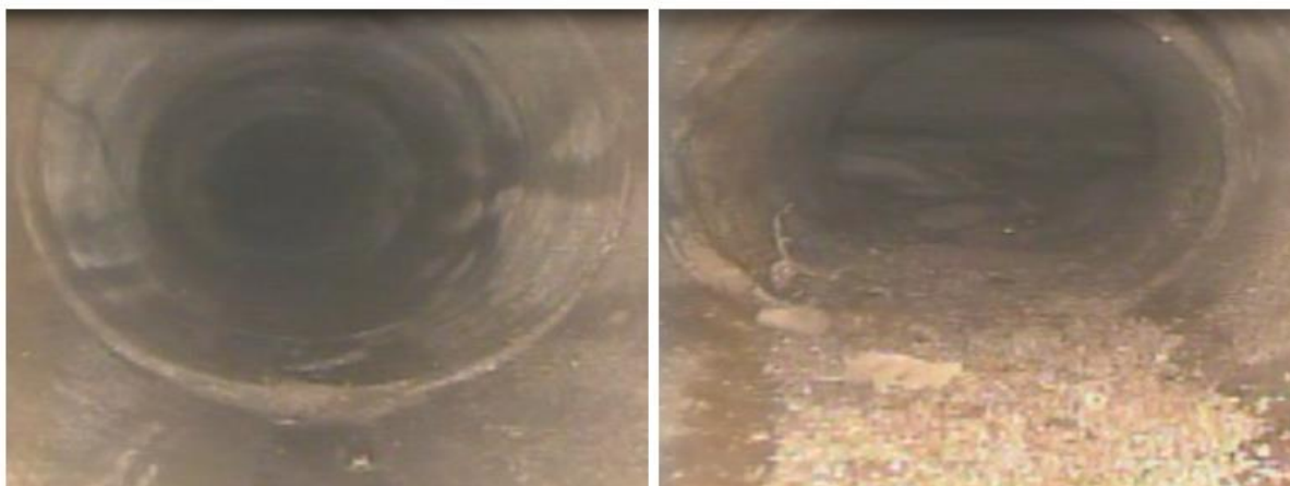
Obr. 4.20 Fotografie vychýlení potrubí (vlevo), usazování částic odpadní vody ve vychýleném spoji na úseku 116508 (vpravo) [75]
