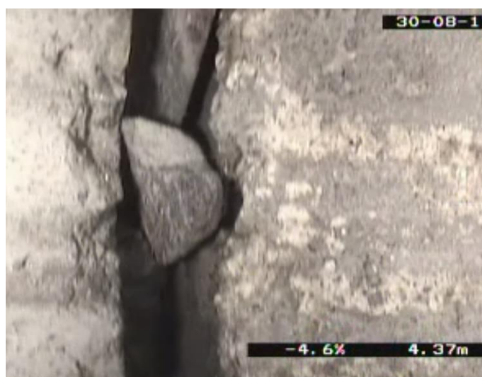
Obr. 4.12 Úlomek potrubí v úseku 120346 [75]
