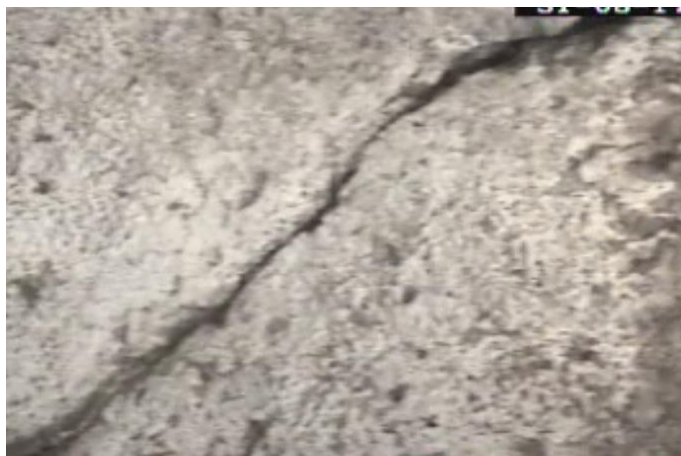
Obr. 4.25 Detail podélné trhliny na potrubí úseku 116511 [75]
