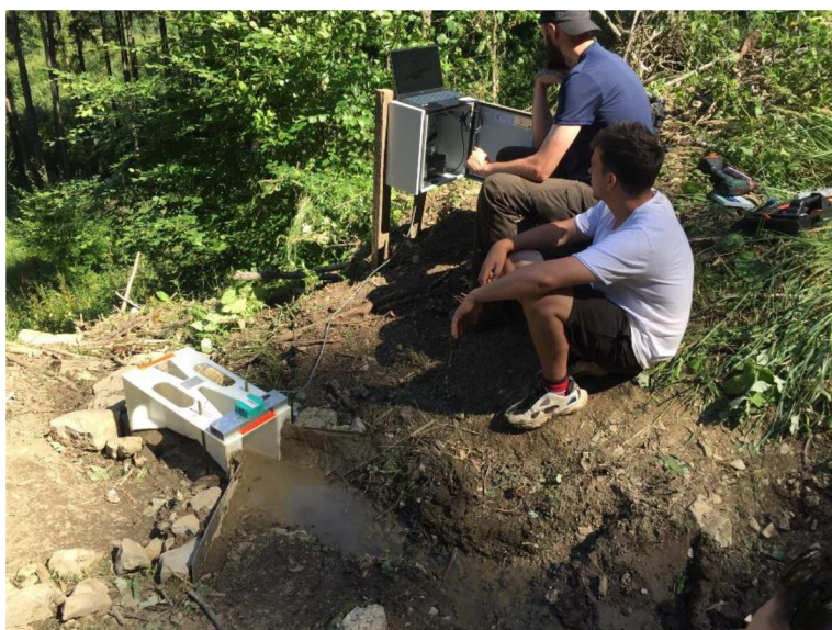
Obrázek 29: Instalace Parshallova žlabu. RNDr. et Mgr. Matěj Horáček a Mgr. Ondřej Vala. Zdroj: Archiv autorky
