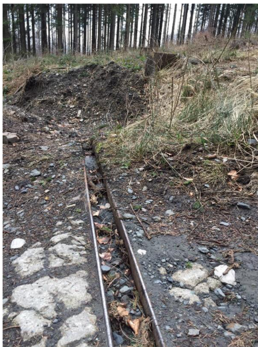
Obrázek 21: Zanesená svodnice pod Velkým Javorníkem. Zdroj: archiv autorky
