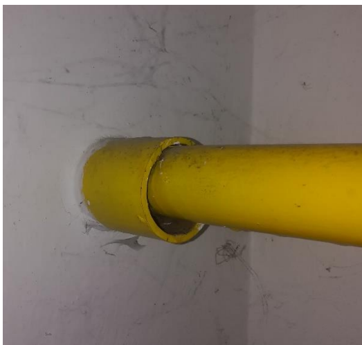
Obr. A.2 – Ocelové potrubí uložené v ochranné trubce (Obrázek z archivu autora)
