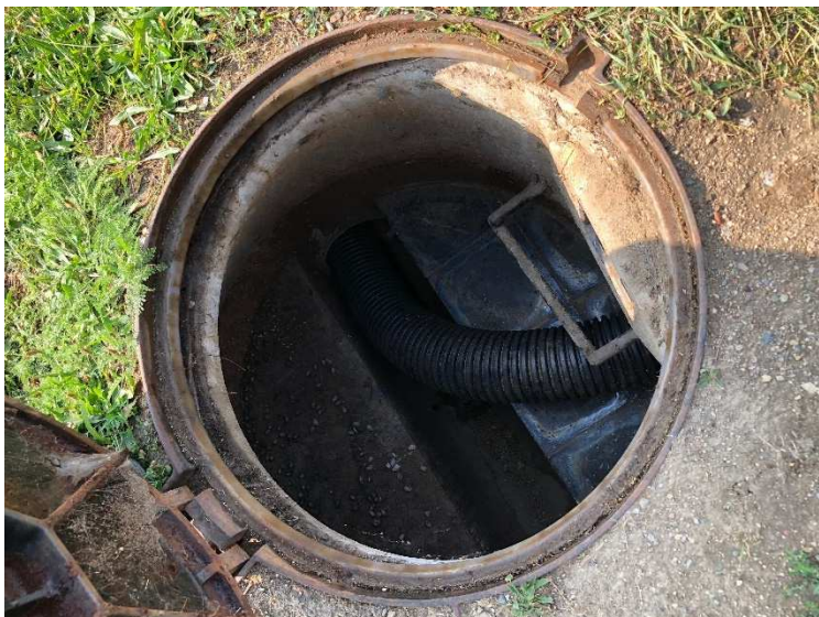
Obrázek 4.9 Detail potrubí z jednotky Plazkat
