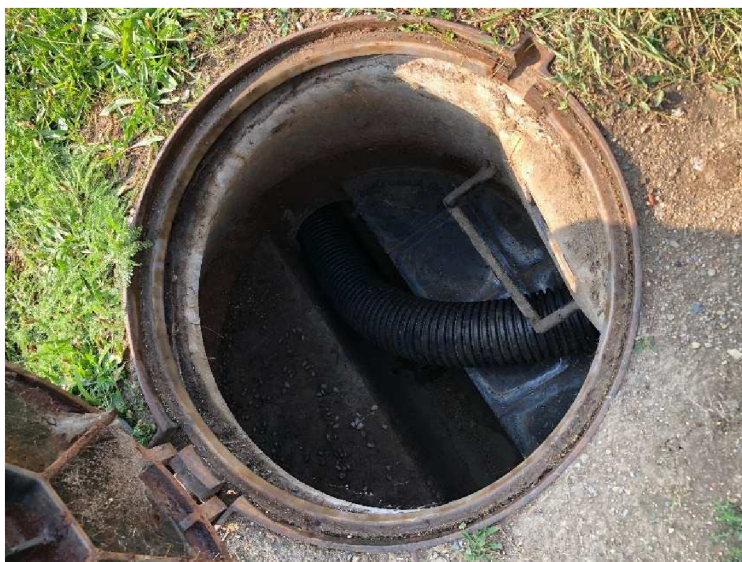
Obrázek 4.9 Detail potrubí z jednotky Plazkat
