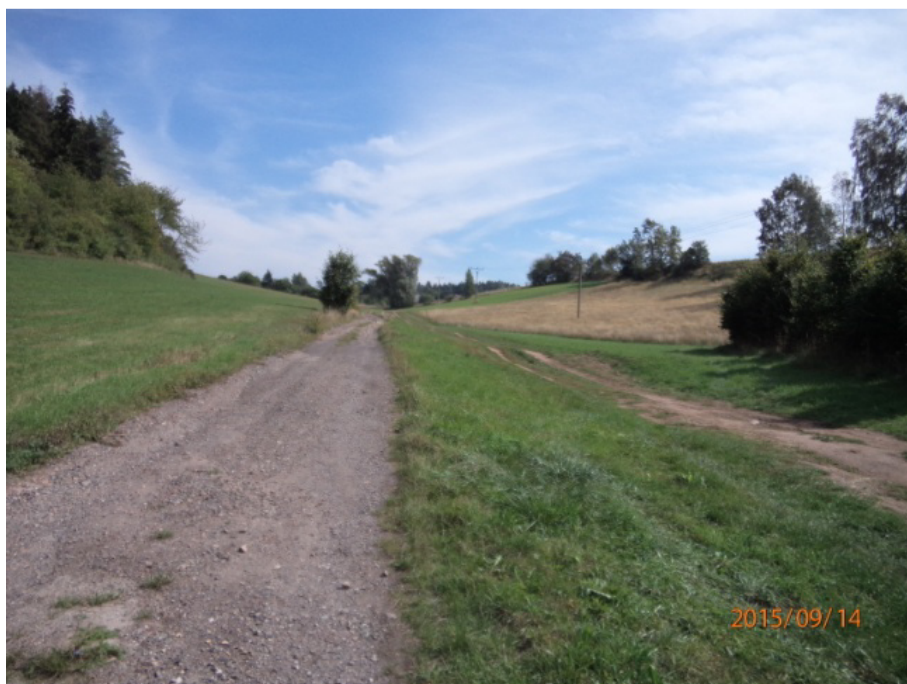
Obrázek 9: Pohled na stávající poškozenou cestu PC5
