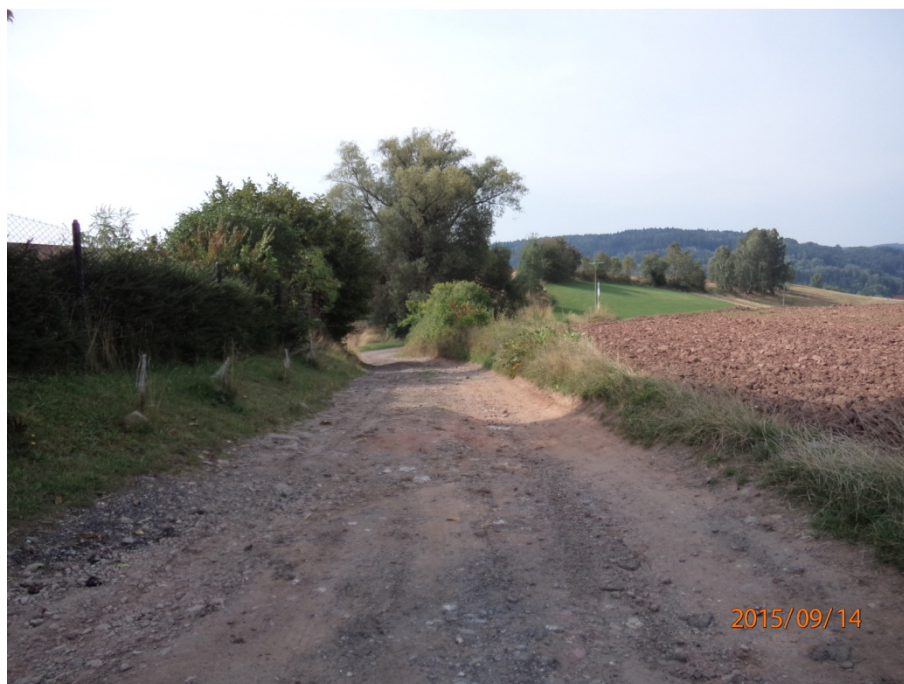
Obrázek 17: Poškozená PC5 pod osadou Kvíčala
