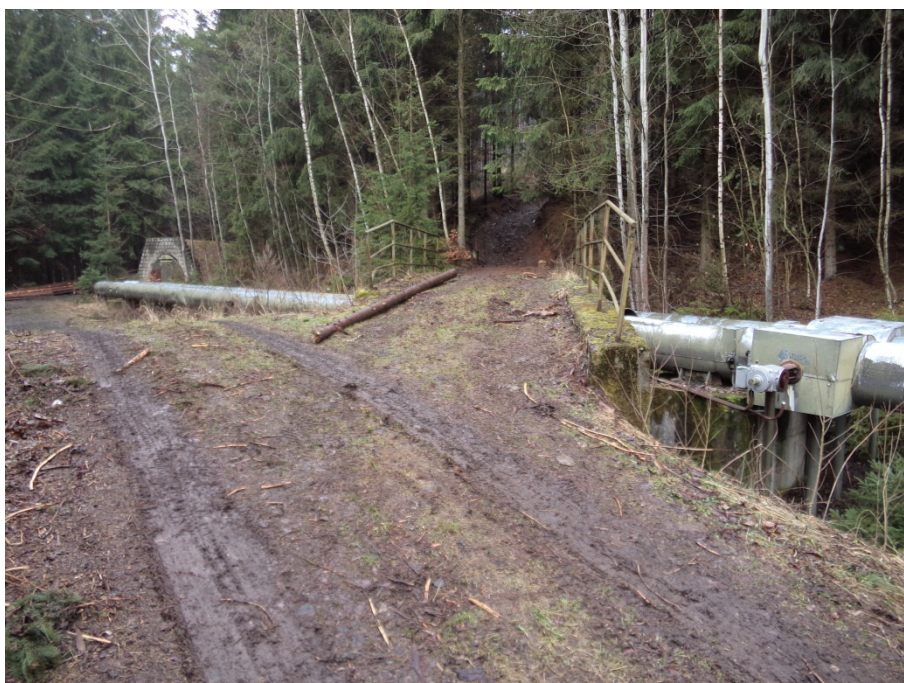
Obrázek 12: Vlevo LC9 a napravo křížení teplovodu a LC10
