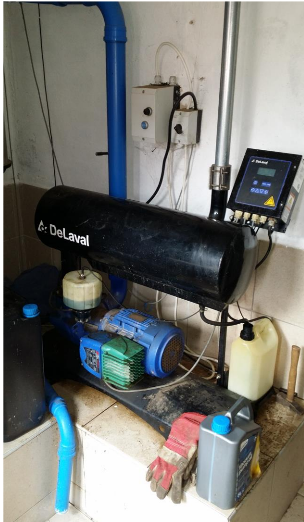
Př. 5 Strojovna DeLaval VMS (Tesař, 2016 (archiv autora))
