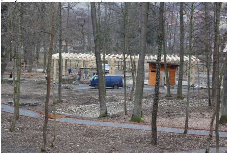
Budování zázemí pro kiosek, sociální zařízení, kryté pódium i hlediště, technické zázemí pro služby / březen 2013. Zdroj: soukromý archiv Andrea Staňková, 2013
