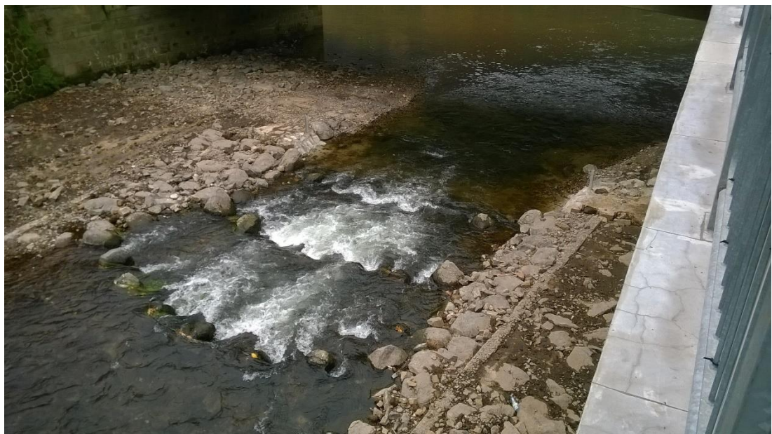
Příloha 6: Rybí přechod Hřensko – patrná sedimentace po zvýšeném průtoku (vlastní archiv, 2014)
