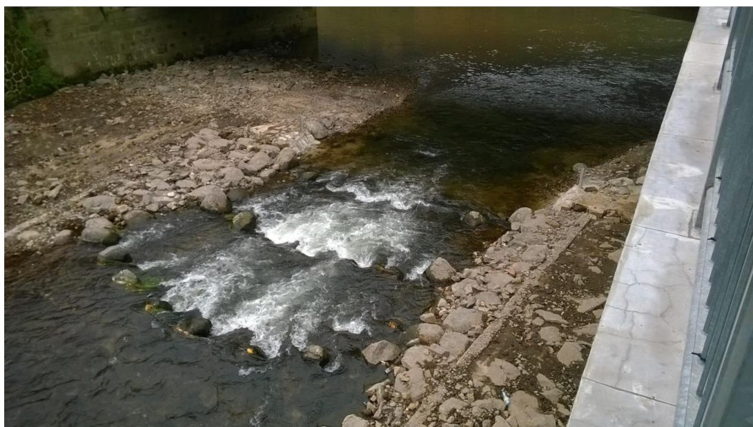
Příloha 6: Rybí přechod Hřensko – patrná sedimentace po zvýšeném průtoku (vlastní archiv, 2014)
