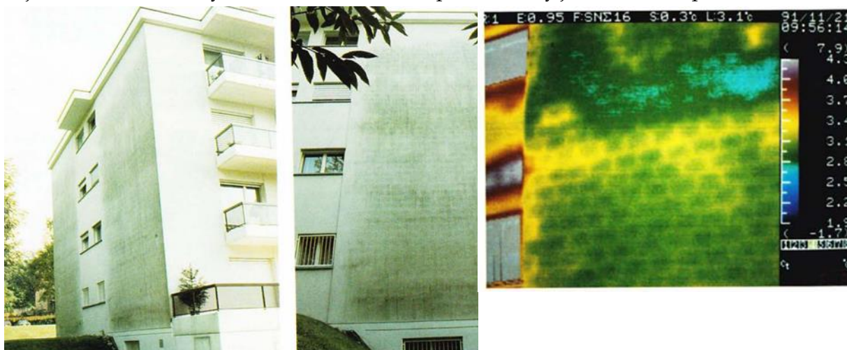
Obr. 3.2: Vlevo fotografie zobrazující stav prošetřované budovy, uprostřed vidíme část severně orientované fasády a vpravo termovizní snímek daného výseku fasády zobrazující rozložení teplot na napadeném povrchu, zdroj [2].
