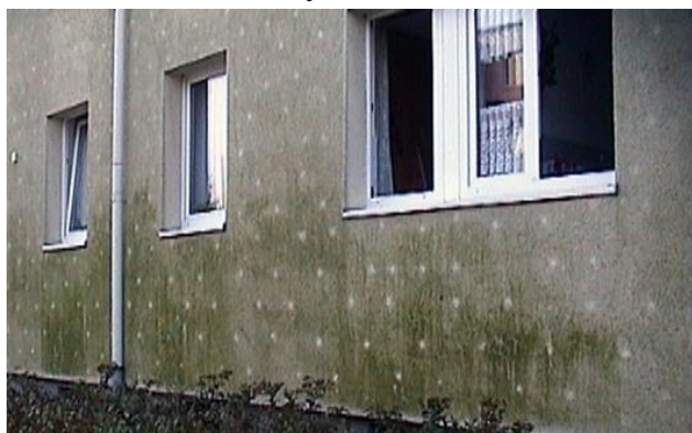
Obr. 3.3: Ilustrační foto; povrch zateplené fasády porostlé řasami, na kterém jsou v místech hmoždinek jasně patrné světlejší kruhové oblasti bez řas, zdroj obrázku - www.eipos.de .
