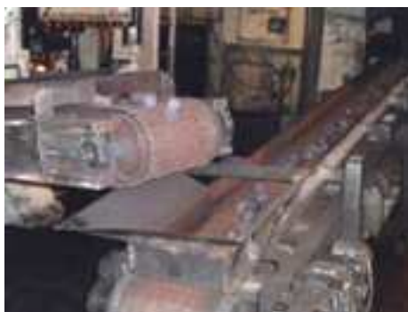
Obr. 64 Výstup ze zakrytého dopravníku
