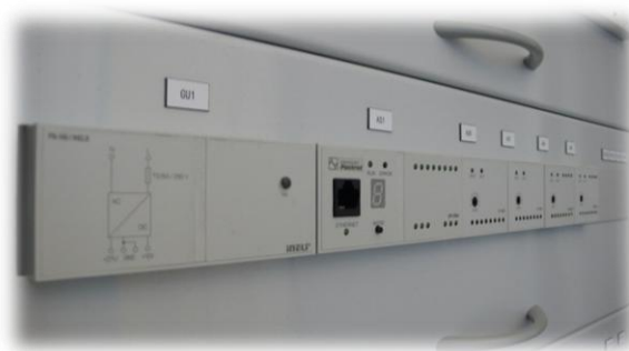
Obr. 5-3 Pohled na jednu z řídicích jednotek v rozváděči RH
