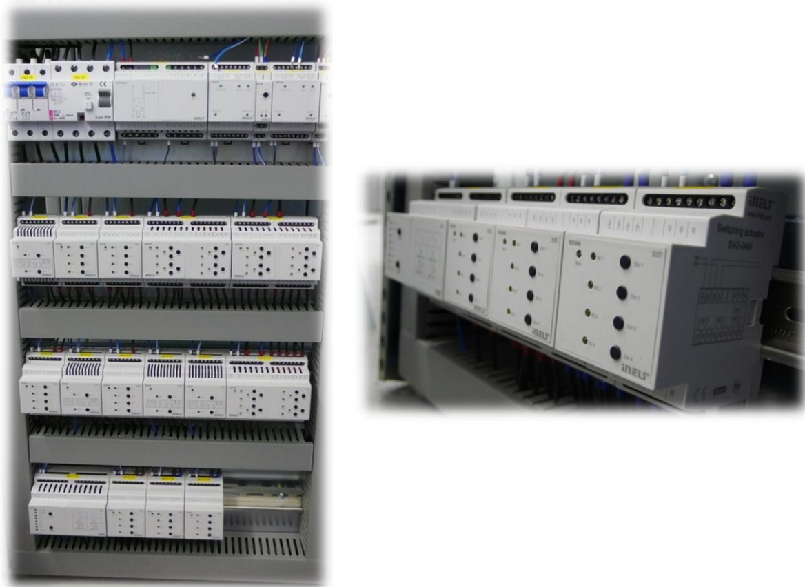
Obr. 5-2 Pohled do rozváděče RP2.0
