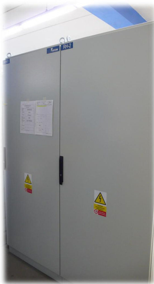
Obr. 5-1 Pohled na hlavní rozváděč RH
