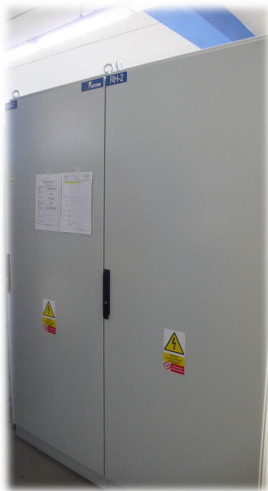
Obr. 5-1 Pohled na hlavní rozváděč RH
