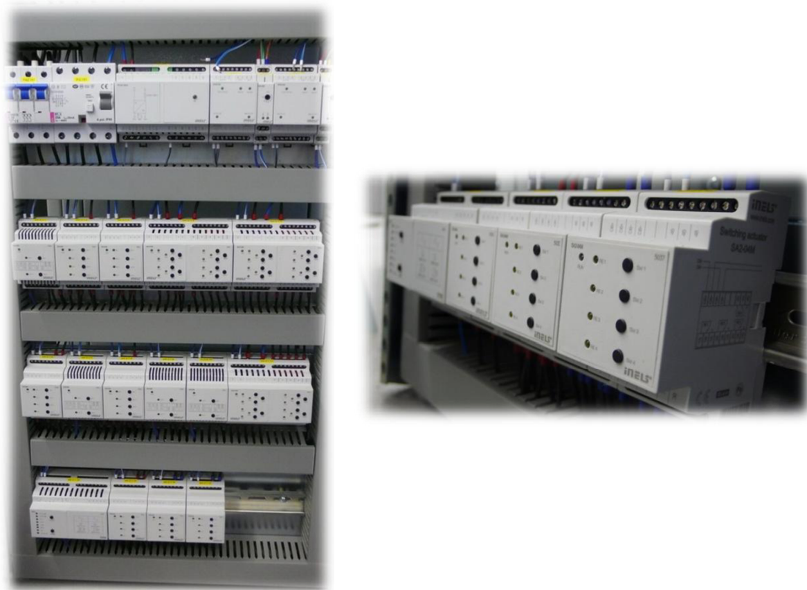
Obr. 5-2 Pohled do rozváděče RP2.0
