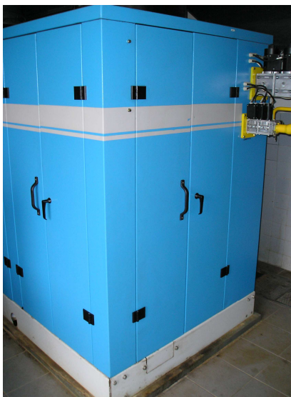
Obr. 14 Kogenerační jednotka (ČOV Šumperk)
