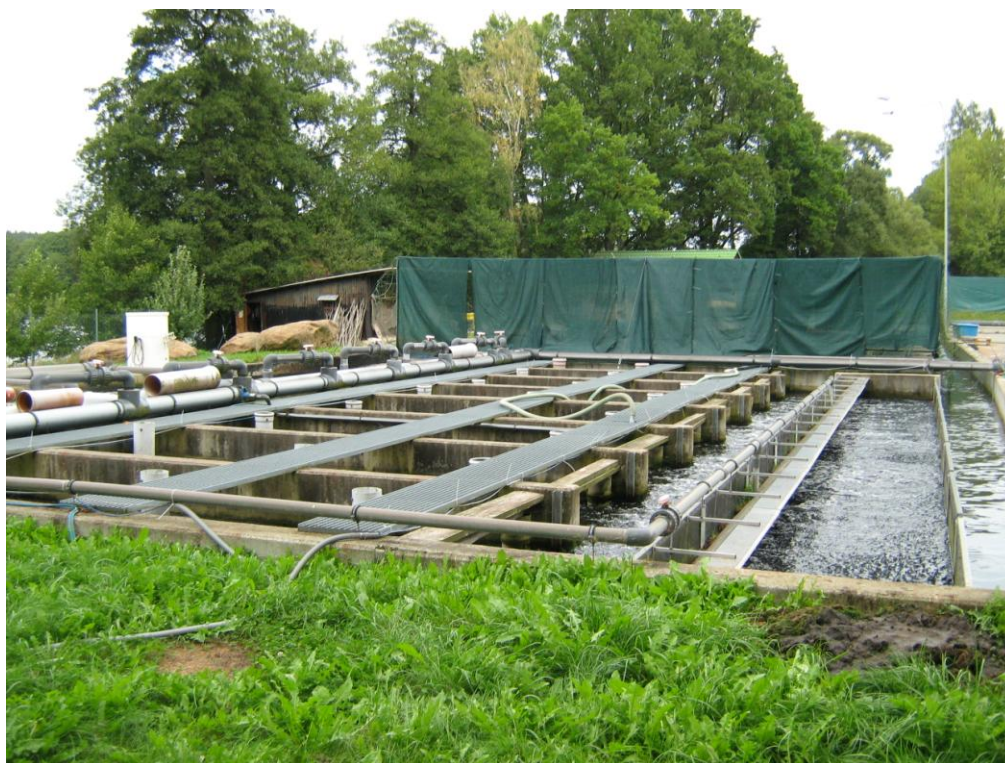
Obr. 1: Pohled na filtrační část recirkulačního zařízení Pravíkov (foto: L. Mareš)
