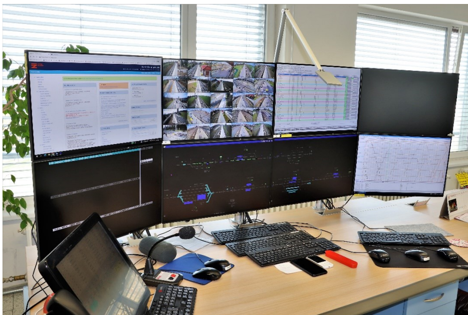
Obr. 3.4 Pracoviště výpravčího na RDP Olomouc
