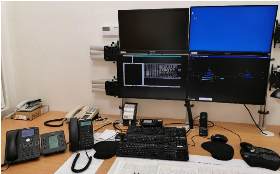
Obr. 1.2 Jednotné obslužné pracoviště v ŽST Šternberk
