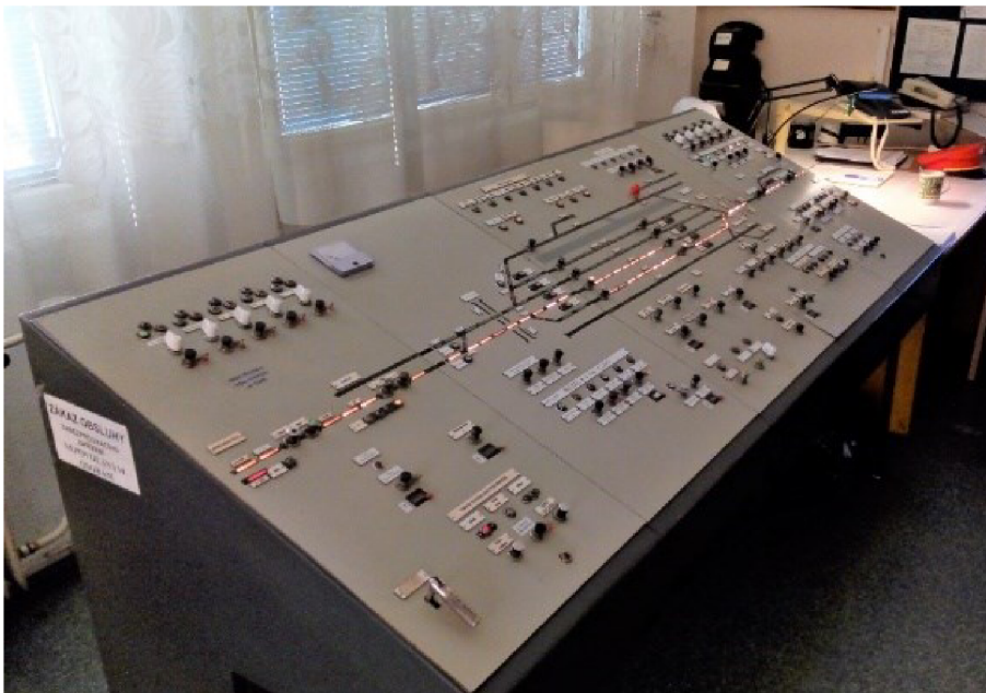
Obr. 1.1 Pult staničního zabezpečovacího zařízení TEST v ŽST Šternberk
