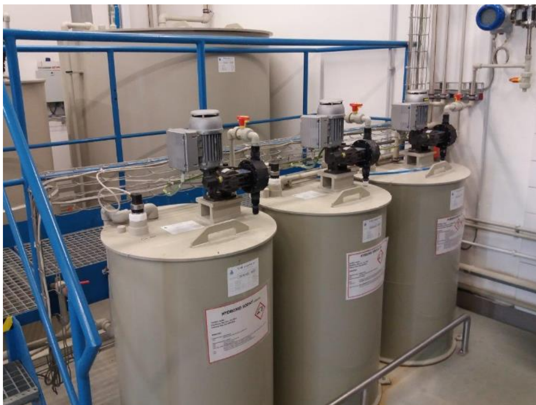
Obrázek 20: Dávkovací nádrže pro kyselinu a louh (Vlastní zdroj)
