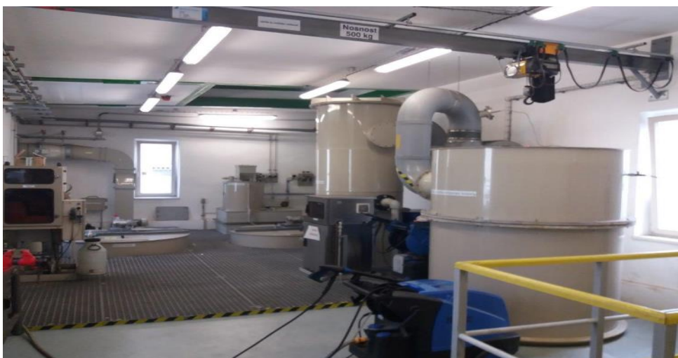
Obrázek 7: Hlavní strojovna na ČOV (Vlastní zdroj)
