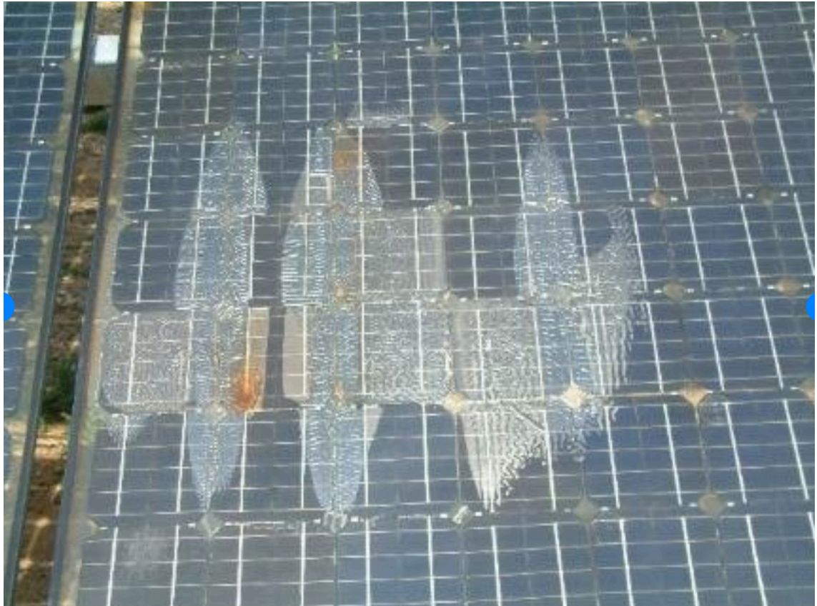
Obrázek 2-2 Delaminace a koroze FV panelu [9]
