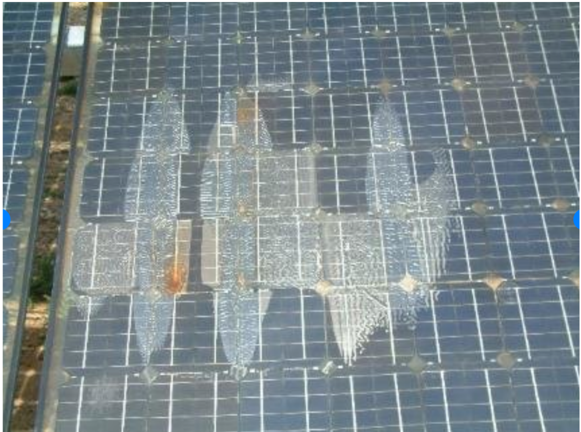
Obrázek 2-2 Delaminace a koroze FV panelu [9]
