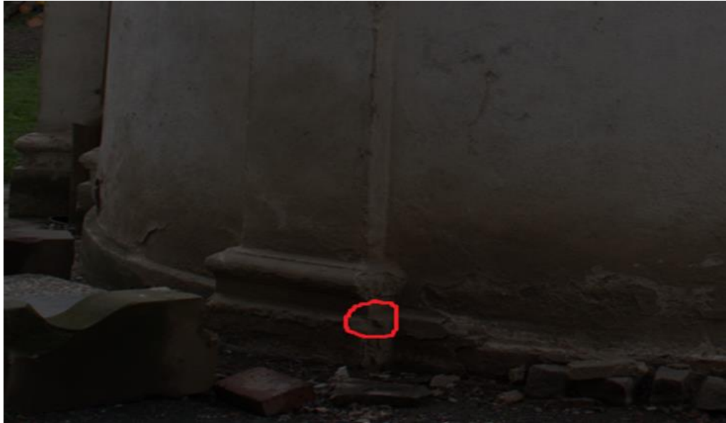
Obr. č. 27 Chybějící hrany
