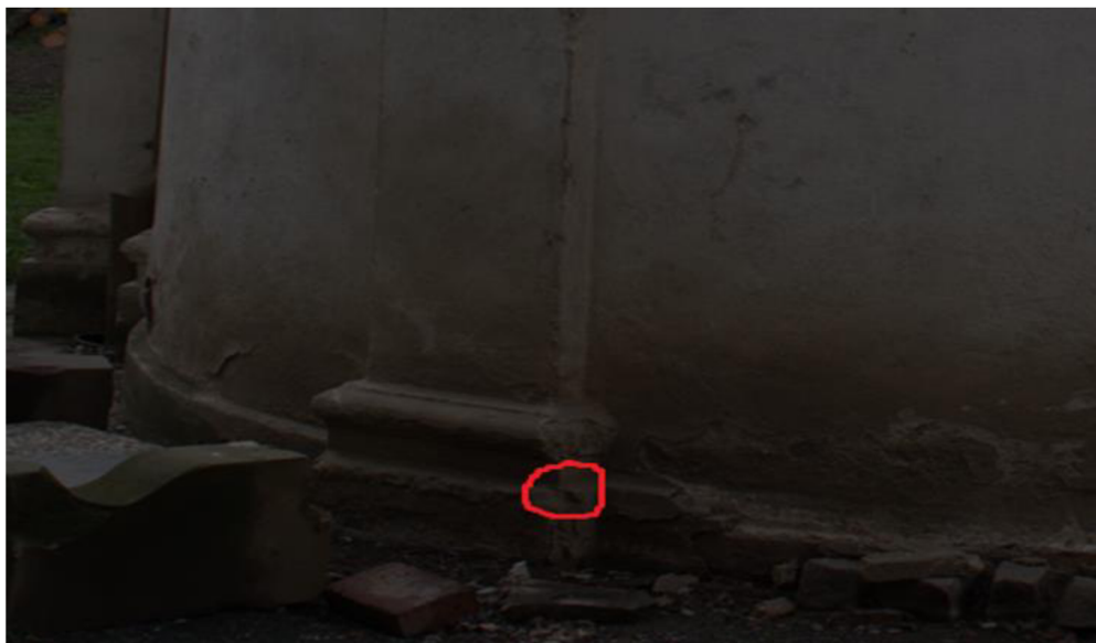
Obr. č. 27 Chybějící hrany
