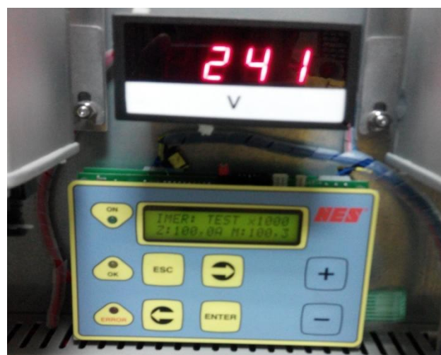
Obr.5-1 Riadiaca jednotka rekuperačnej komory
