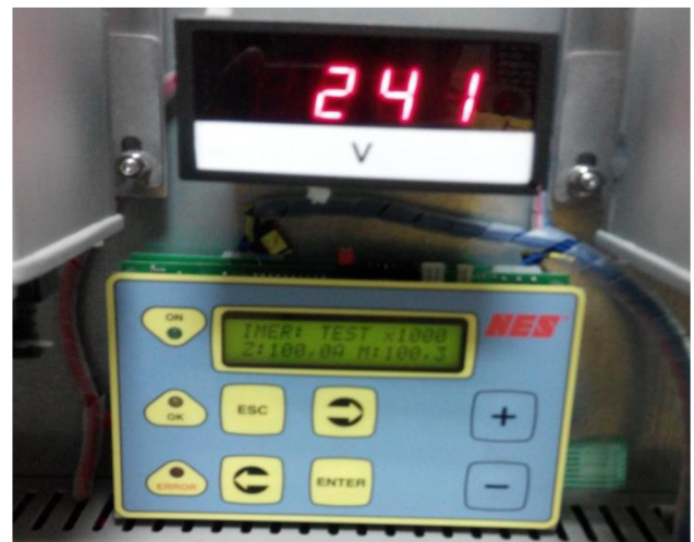
Obr.5-1 Riadiaca jednotka rekuperačnej komory
