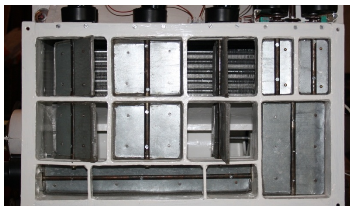
Obr. 53: Pohled na ventilační klapky distribuční skříně
