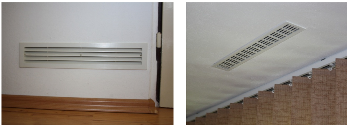
Obr. 57: Ventilační výdechy v testovaném domě: přívod vzduchu (vlevo), odvádění vzduchu (vpravo)
