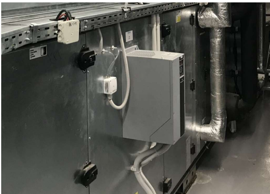
Obrázek 13: Frekvenční měnič pro ovládání ventilátoru VZT [vlastní]
