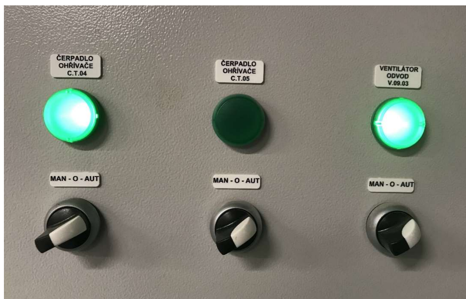
Obrázek 17: Přepínače pro čerpadla a ventilátor [vlastní]
