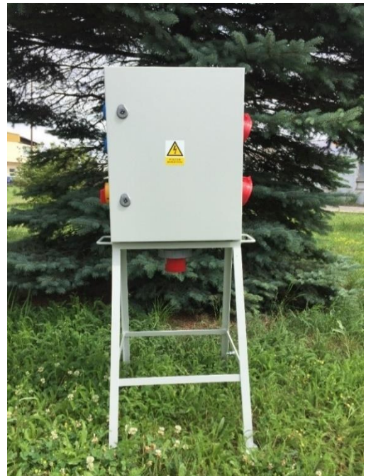
Obrázek 30: Staveništní rozvaděč RA411 [7]
