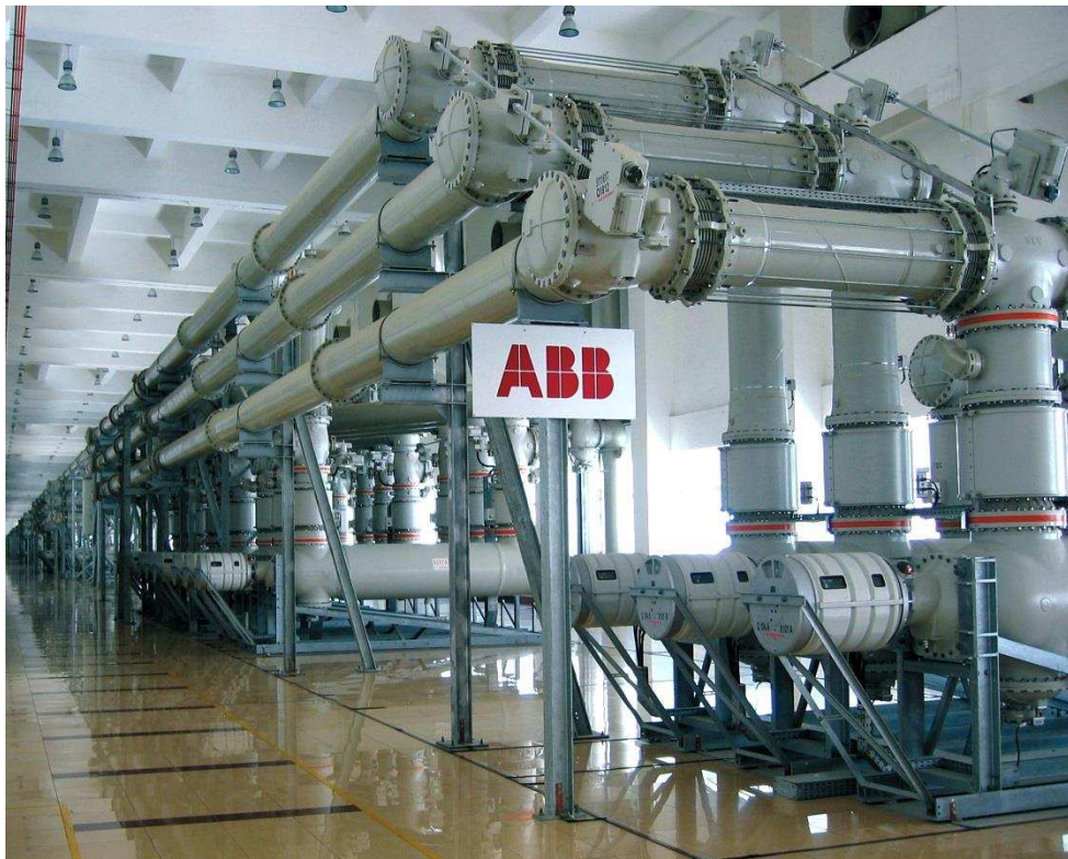
Obr. 9) Rozvodna od firmy ABB na přehradě Tři soutěsky [6]
