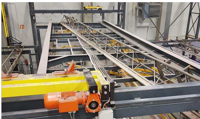
Obr. 28) Pád šíny v důsledku chyby SW
