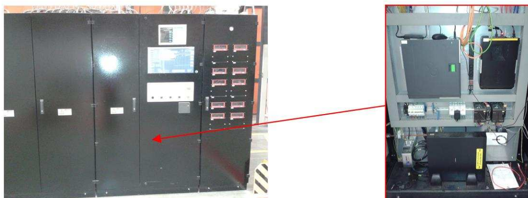
Obr. 26) Rozvaděč lakovací linky
