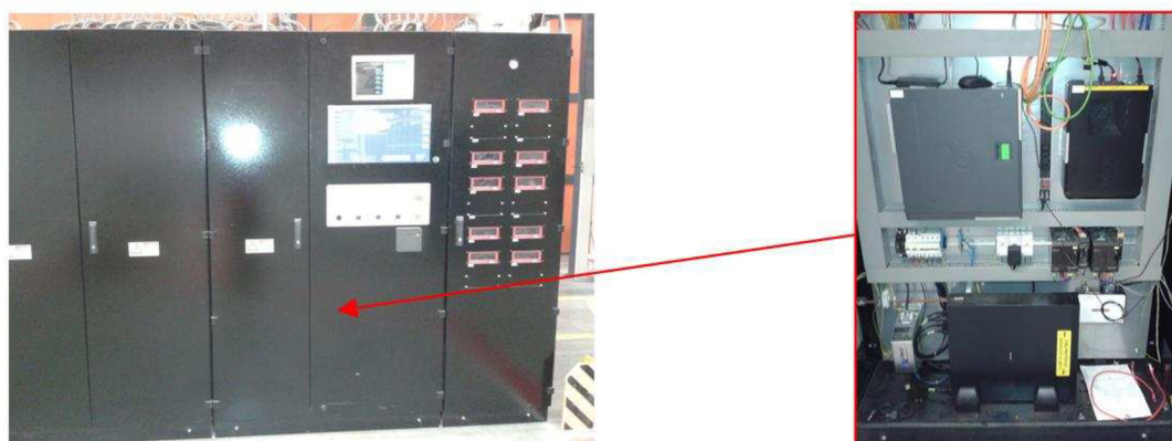
Obr. 26) Rozvaděč lakovací linky
