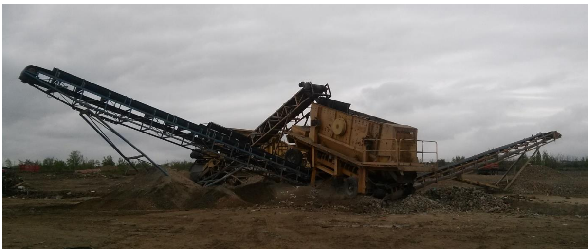
Obr. 11 Celkový pohled na třídíč a pásové dopravníky.
