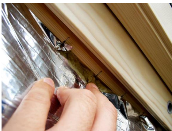
Obr. 61: Chybně provedená vzduchotěsná vrstva 1 (zdroj: [46])
