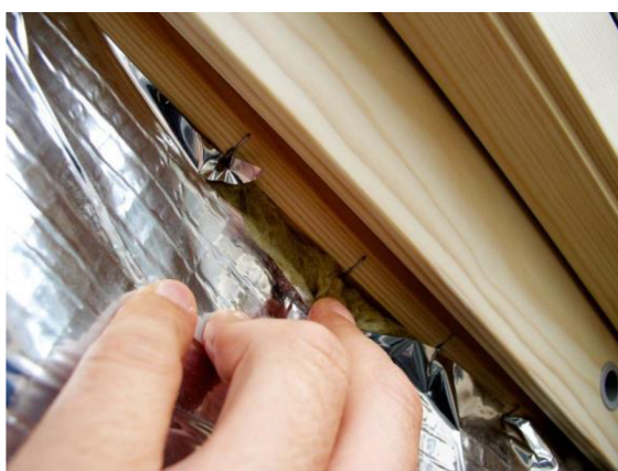
Obr. 61: Chybně provedená vzduchotěsná vrstva 1 (zdroj: [46])
