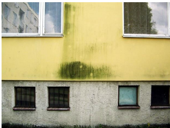
Obr. č. 12 Řasy na fasádě. [37]
