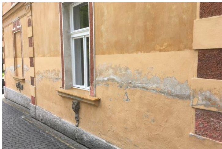
Obr. č. 13 Výkvěty na fasádě [24]
