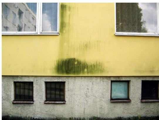
Obr. č. 12 Řasy na fasádě. [37]
