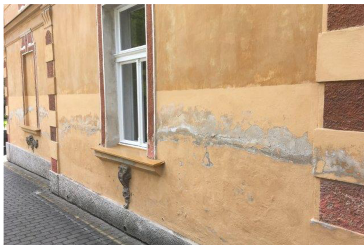
Obr. č. 13 Výkvěty na fasádě [24]
