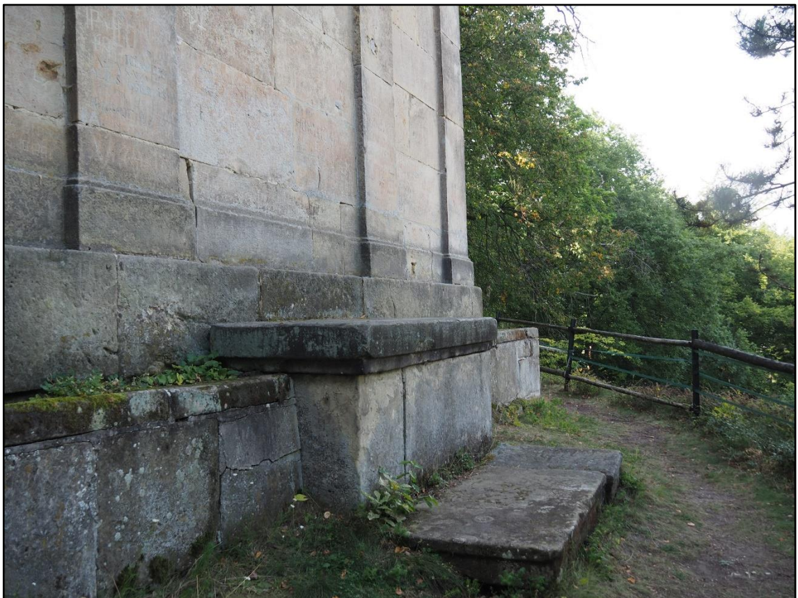
Obr. 26: Ztenčující prostor okolo Lorety z důvodu ujíždějícího svahu, září 2021
