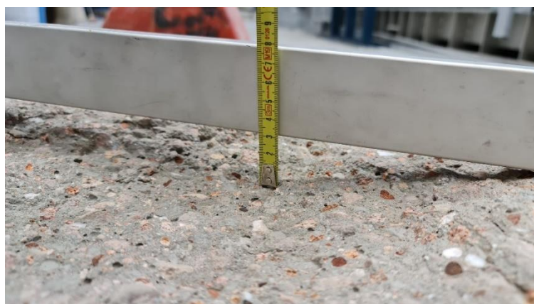
Obrázek 55: Měření hloubky odprýsknutí na panelu REF
