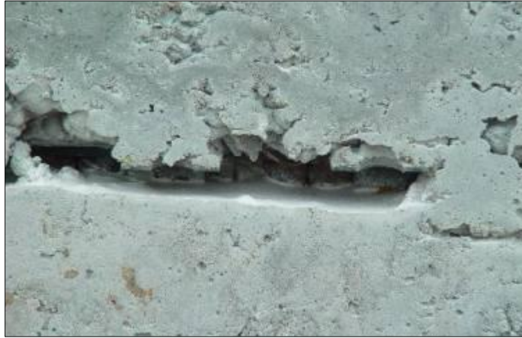
Obr. 11: Kaverna vzniklá nedokonalým zhutněním betonové směsi [O27]
